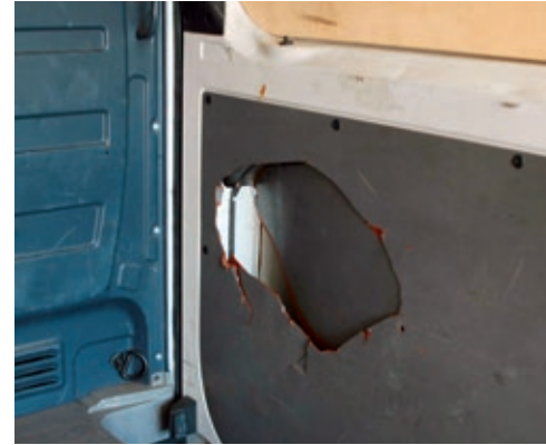
Bruch der Verkleidung
